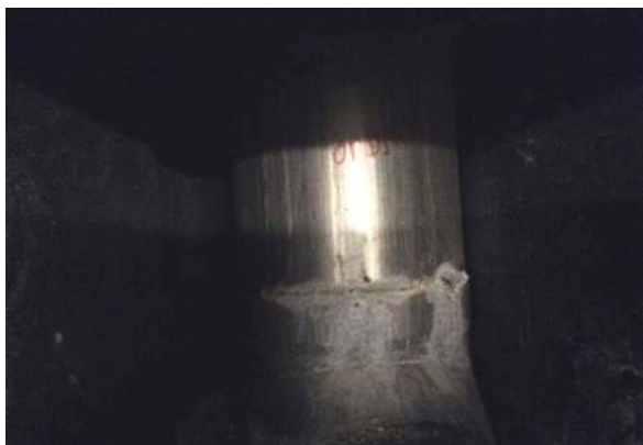
Lekkage door corrosie
